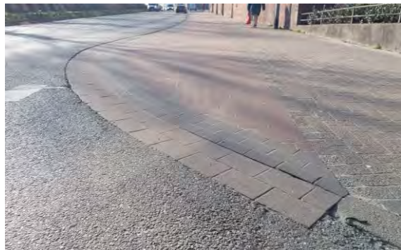
Absenkung Bordstein auf 0 cm
